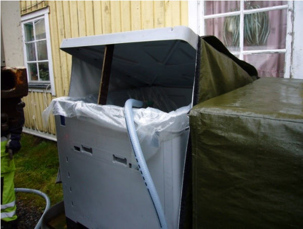
Figur 4. Påfyllning av en nödvattentank. Tanken till höger är omsluten av ett isolerande skydd för att undvika att vattnet fryser vid minusgrader.
